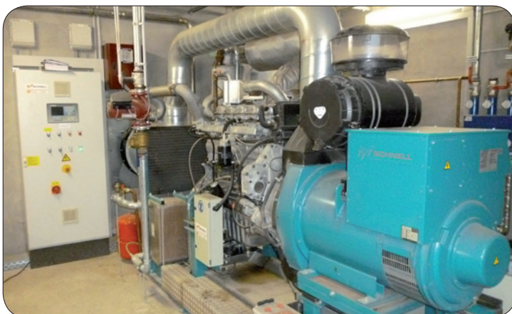
Développement d'unités de cogénération électricité-chaaleur ▲
